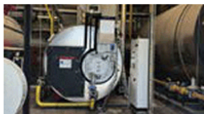
新型ボイラーの導入
