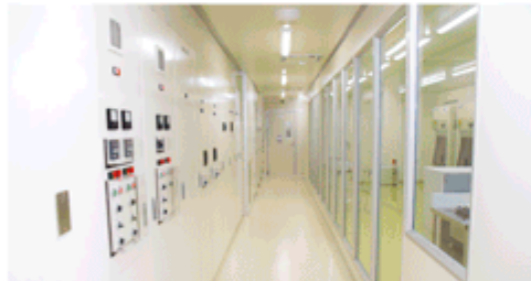
横浜細胞処理センター内部
