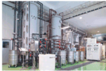
本社 化学品工場 イオン交換樹脂再生設備
