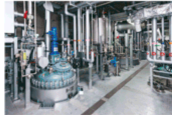
本社 医薬品工場 原薬合成設備
