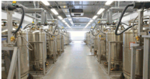
細胞保管センター内部
