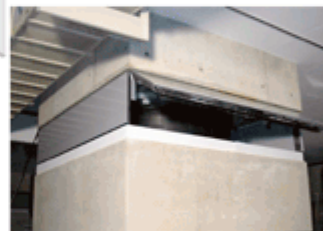
免震装置の耐火被覆
