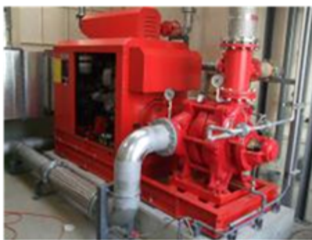
非常用動力装置
