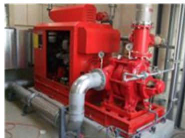
非常用動力装置
