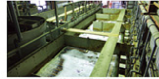
排水処理施設
