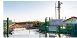
施設入口・トラックスケール
