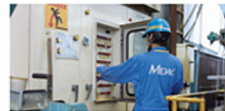
凝集沈殿処理制御装置
