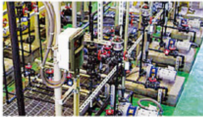
浄水場等に設置された当社製品
