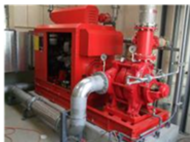
非常用動力装置
