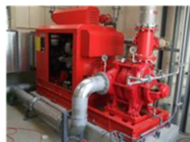
非常用動力装置
