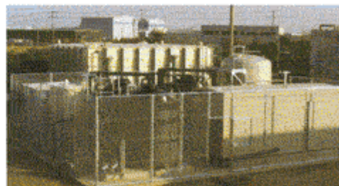
地下水飲料化システム（RO膜）
