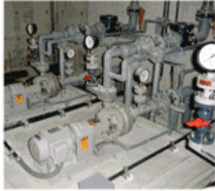
水族館で使用の海水ポンプ
