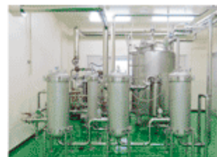
(フィルター濾過装置)
